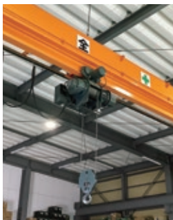
お客さまの課題に対して、設備の更新を提案した事例。省エネ効果の向上と、作業効率の改善を実現した
